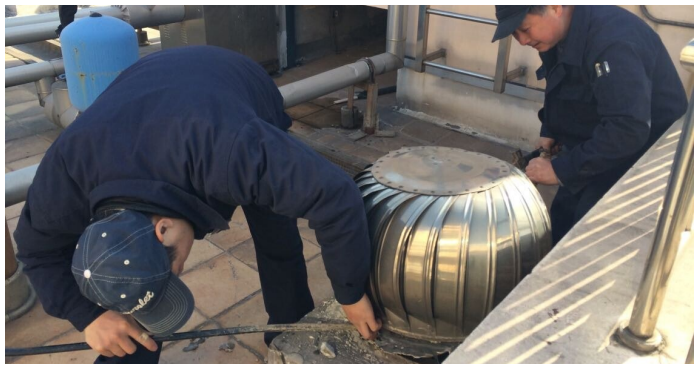
天山华庭8号单元业主家中厨房烟道渗水,管理处随即派维修师傅前往检修。
